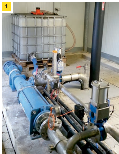
Pumpstation mit Behälter für Nährlösung.
